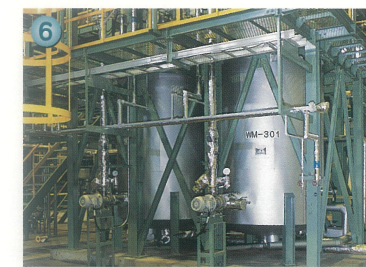
フレーク洗浄装置
