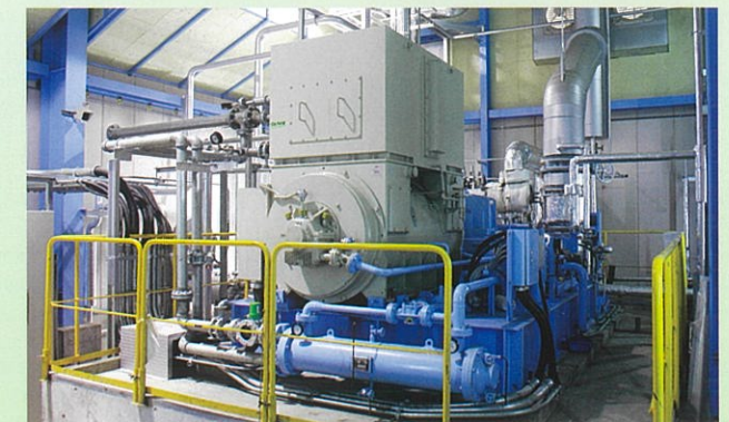
蒸気タービン発電機
