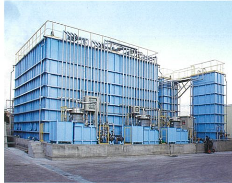
廃液受入タンク
