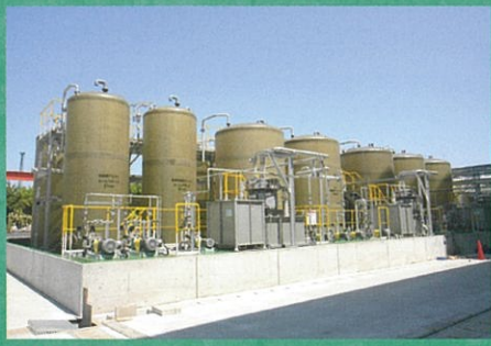
廃液受入設備
