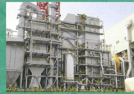
ボイラ+二次燃焼室
