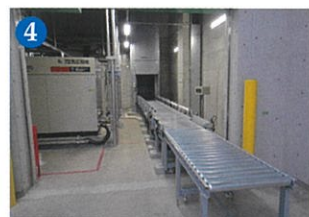
4 直接投入装置
