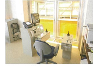
クレーン操作室
